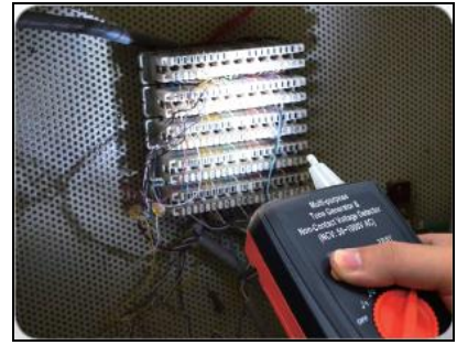
Распределительная колодка (плиты)
